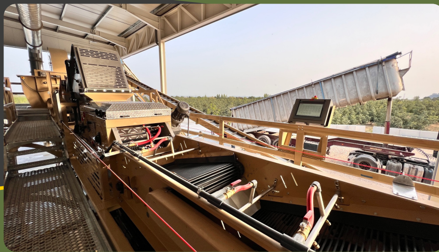
Системы мойки конвейерных лент JESSEE и главная панель управления
